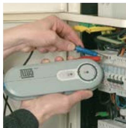
DT-500 sur installation consignée hors tension
